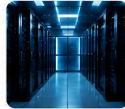
تجهيز غرف الخوادم
